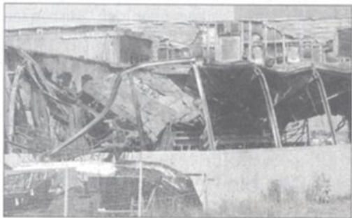
Unmittelbar hinter diesem Bereich brach das Feuer aus. Foto: Wegner
