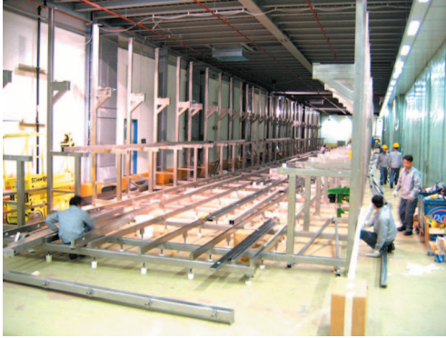
Der Galvanoautomat in der Anfangsphase (18.1.2006)
